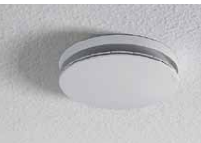
Zuluft Ventil Decke
